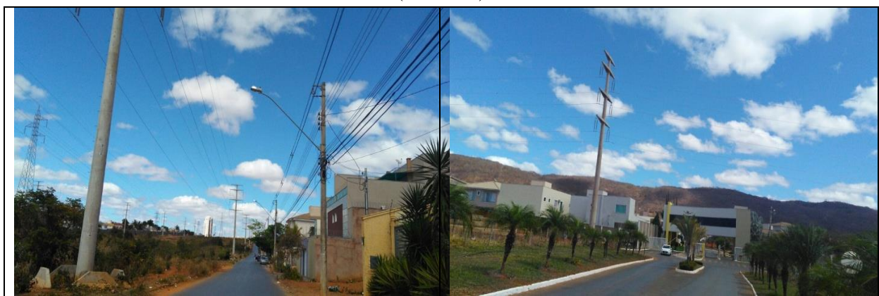
Foto 04: Linhas de Transmissão da CEMIG próximas aos condomínios do Jardim Brasil (Parte IV)
