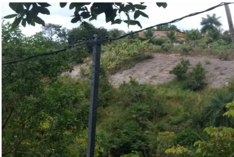
Figura 6 - Encosta sem cobertura vegetal natural devido ao desmate. (vista da rua dos Mineiros, bairro de Aldeia dos Camarás, Camaragibe–PE)
