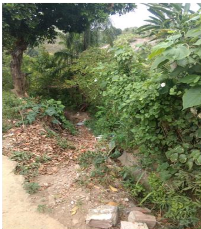
Figura 3 - Erosão regressiva na borda do tabuleiro em margem de arruamento (rua dos Mineiros, bairro de Aldeia dos Camarás, Camaragibe–PE)
