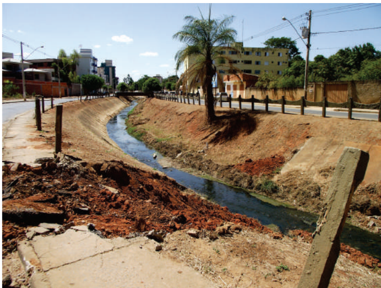
Foto 2: Deteriorização da manta asfáltica, calçada, muretas de proteção, canal Rio Vargem Grande, Av. Vicente Guimarães, Ago/2010.
