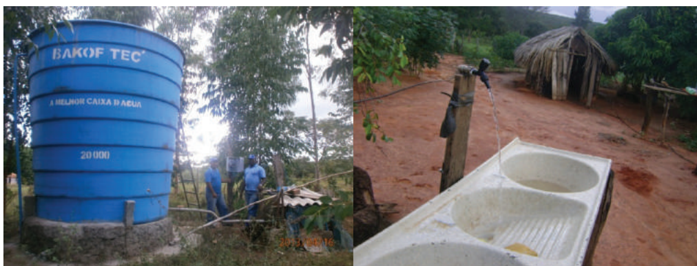
Foto 2 – Instalação de reservatório de 20m e automação do sistema na Comunidade de Varginha
