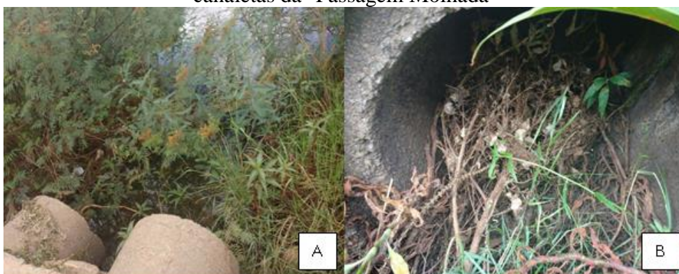
Figura 9- (A) Canaletas tomadas pela vegetação e (B) detalhamento de uma das canaletas da "Passagem Molhada"
