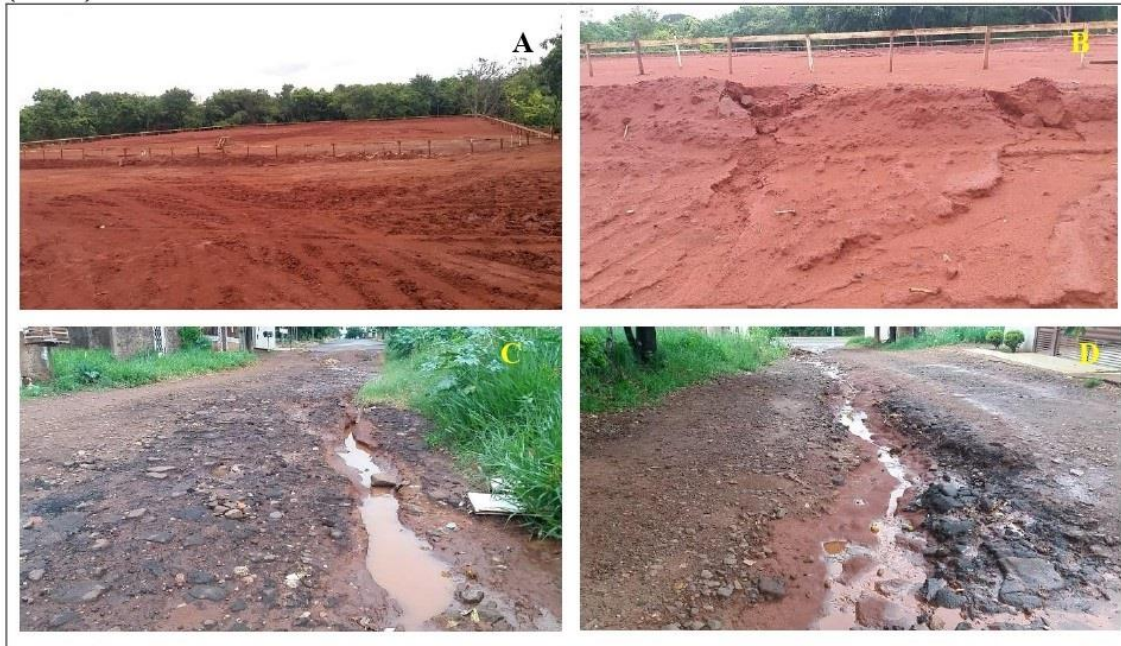
Figura 7: Terraplanagem com formação de ravinas (A, B); sulcos e ravinas em vias não pavimentadas e com sistema de drenagem pluvial inexistente (C, D)
