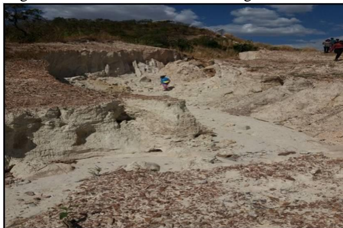
Figura 17 – Processo erosivo as margens da rodovia
