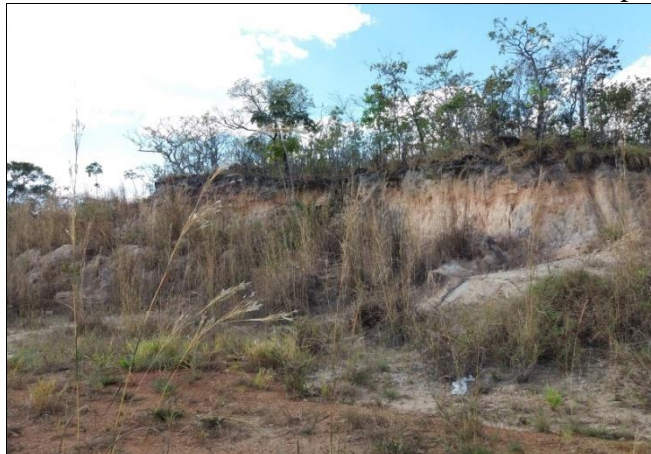
Figura 19 – Processo erosivo acelerado em área de empréstimo.
