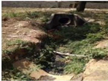
Lançamento de efluente na nascente em 2015
